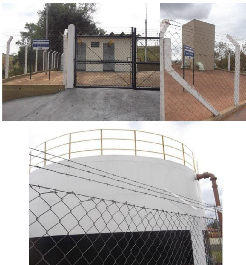
Figura 15: Fotos obtidas das EEAB-1 e EEAB-2.
