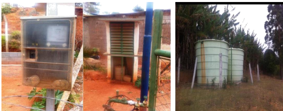
Figura 19: Poço, bomba e reservatório de água do Bairro de Posses
