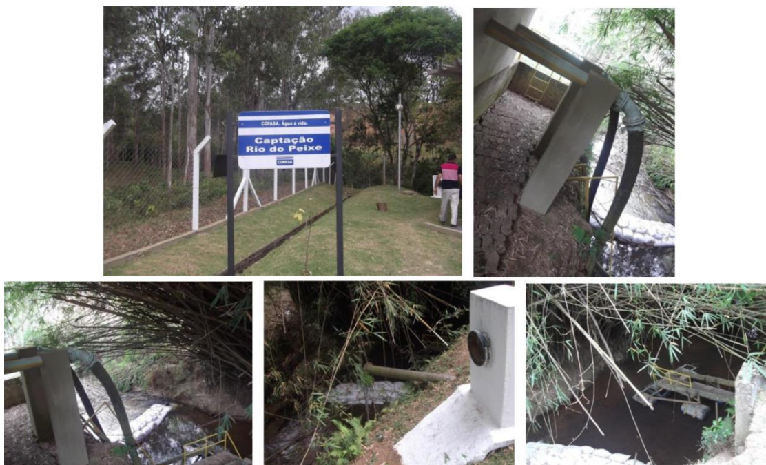
Figura 14: Fotos do sistema de captação de água do Rio do Peixe
